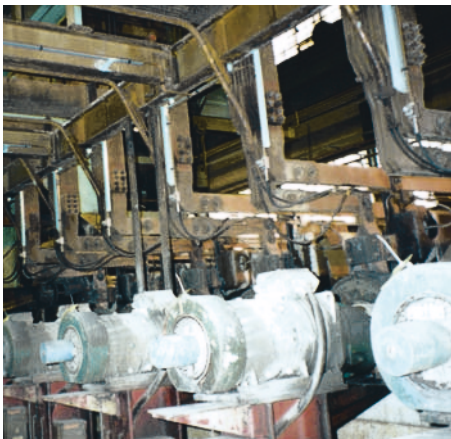
Photo 1. Cuve d'électrolyse pour l'étamage de tôles. Vue des amenées de courant.
